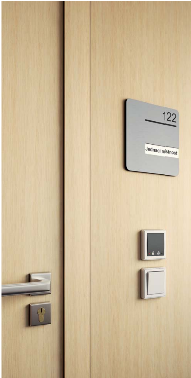
Das Holzpaneel mit dem Schalter und Zutrittssystem bestückt
